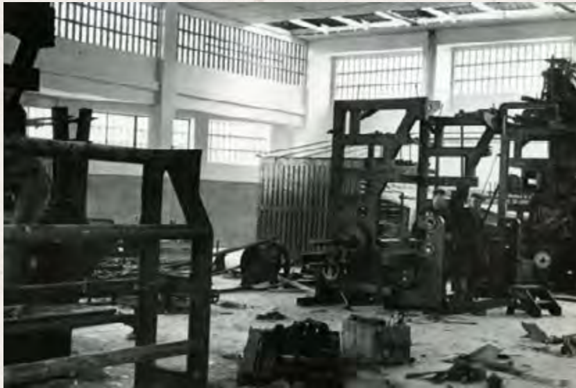
Montaje de telares automáticos en la nave o construcción 4 en 1964. Archivo Fotográfico Alfombras Imperial.
