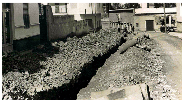
AMCR, Fondo fotográfico Joaquín Pérez Galipienso, Obras de alcantarillado de la Avenida de Madrid , 1967-1968. Sig. 3/8.
