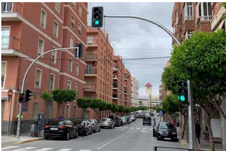
Instalación de un nuevo semáforo en Ronda Sur a petición de los vecinos y vecinas
