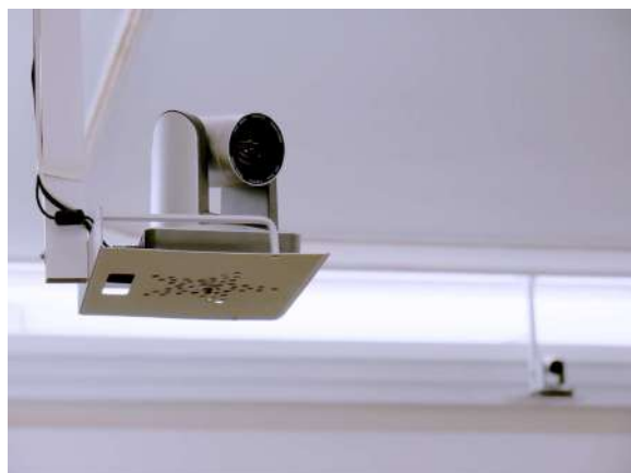
Sistema de cámaras del Salón de Plenos
