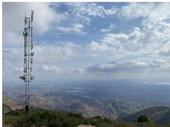
Estación meteorológica instalada en La Vella
