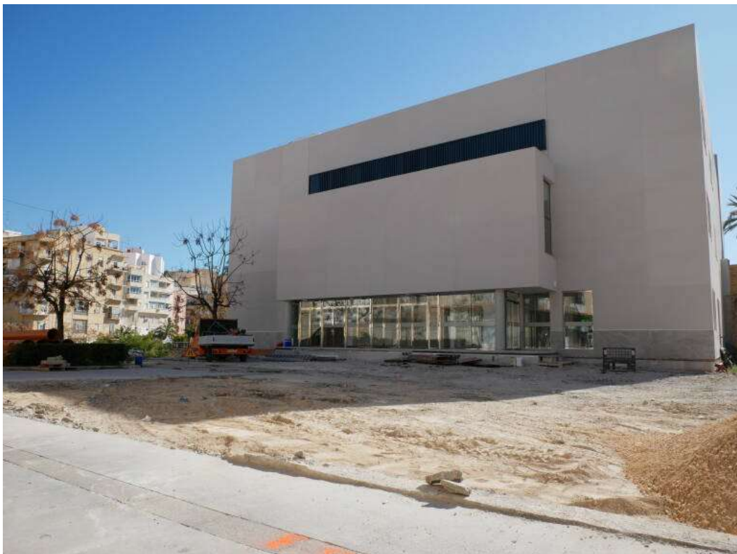
Arrancan las obras de construcción de la Plaza del Teatro Chapí de Crevillent y la adecuación de sus accesos
