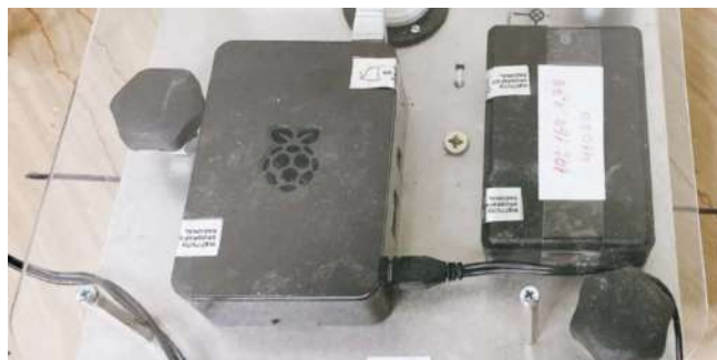
Detector de movimientos sísmicos instalado en la Casa Consistorial
