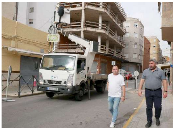
Renovación del alumbrado público, que ahora es de LED
