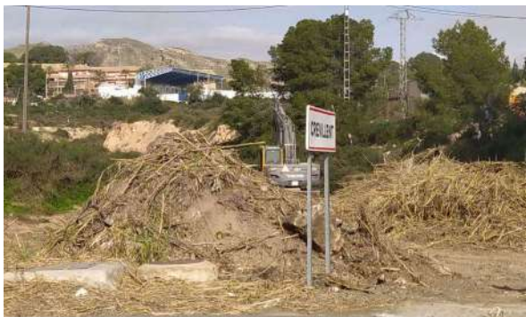
Ejecución de tareas de desbroce en la Rambla, a la altura de uno de los accesos de Crevillent
